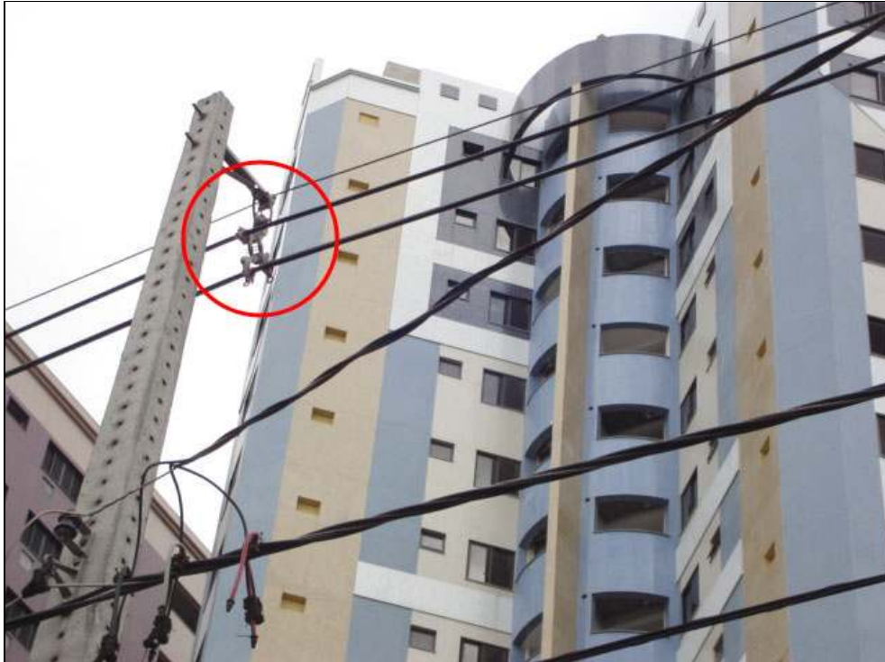
Figura 4.5 Rede aérea compacta de alta tensão
