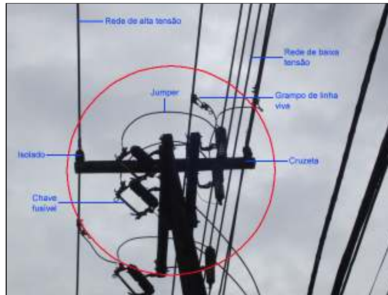
Figura 4.2 Rede aérea convencional alta tensão Fonte: Carla F. Marek (15/07/2007)
