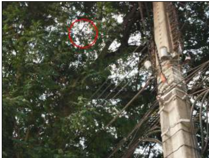
Figura 4.8 Detalhe rede compacta passando entre a copa da árvore
